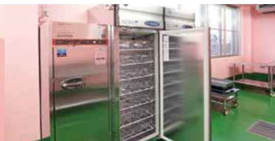
器具消毒保管庫・検食用冷凍庫
